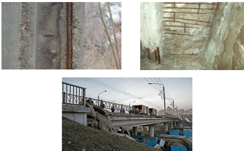
Рис. 1. Коррозия металлической арматуры и её последствия
