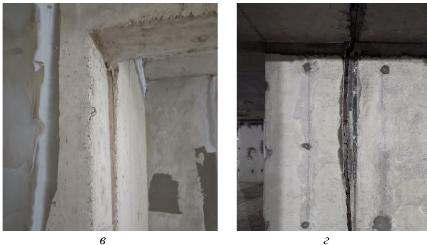
Рис. 1 Виды дефектов монолитных железобетонных конструкций: а) раковины в теле бетона, б) непроектный рабочий шов бетонирования, в) нарушение геометрии дверного проема, г) смещение деформационного шва от проектного положения.
