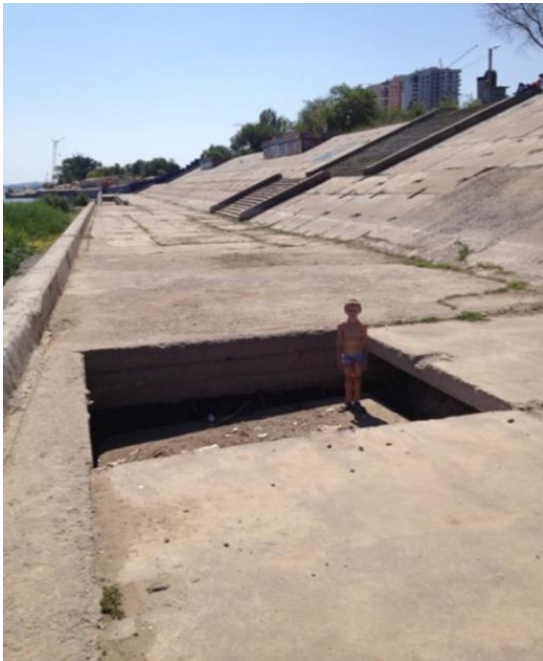
Рис.3. Провал плиты, примыкающей к нижнему ростверку, разграничивающему укрепленный склон и пойму р. Волга
