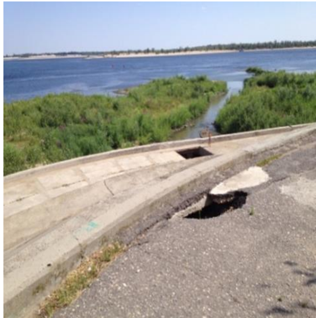
Рис.4. Суффозионный провал в верхней части откоса. Направление выноса грунта в сторону провала плиты в нижней части склона.
